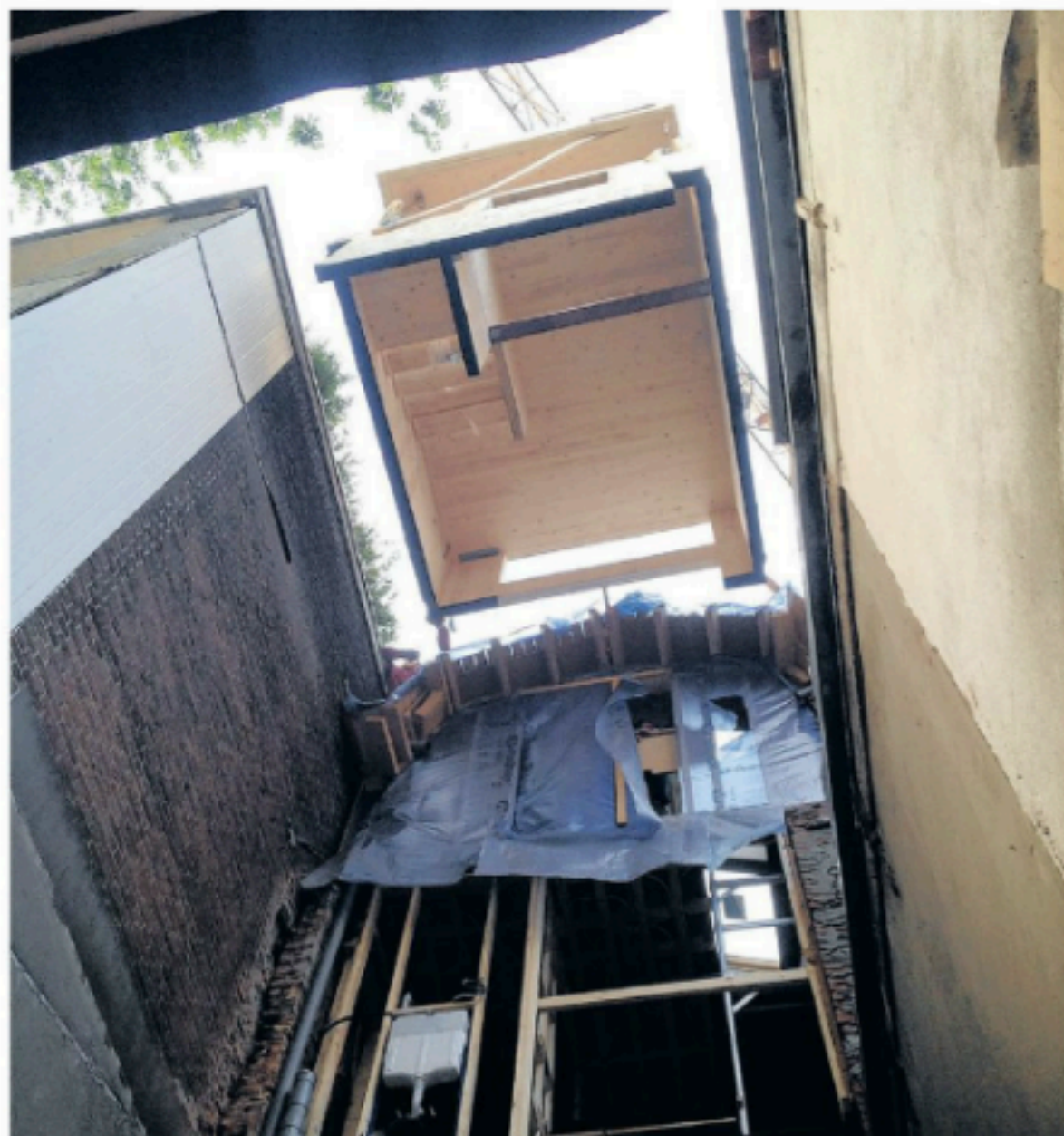
De aanbouw hangt op zijn plek en kan gaan zakken.
